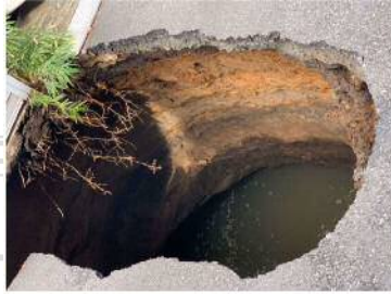
陥没箇所状況写真
