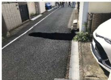
・陥没箇所の状況 (令和2年10月18日12:30)
