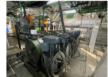
鈹物系添加材注入ポンプ
