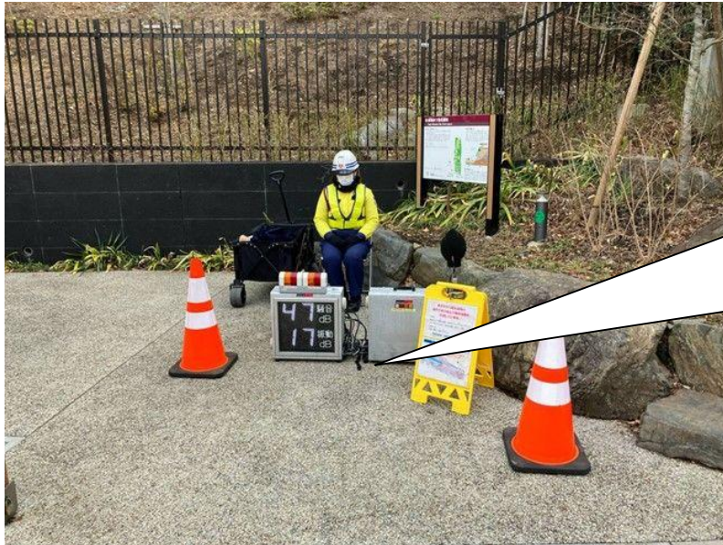
【地中拡幅施工箇所直上付近での振動・騒音の値（簡易計測値）の表示】
