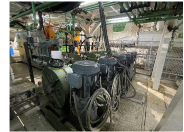
鈹物系添加材注入ポンプ
