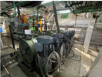
鉍物系添加材注入ポンプ
