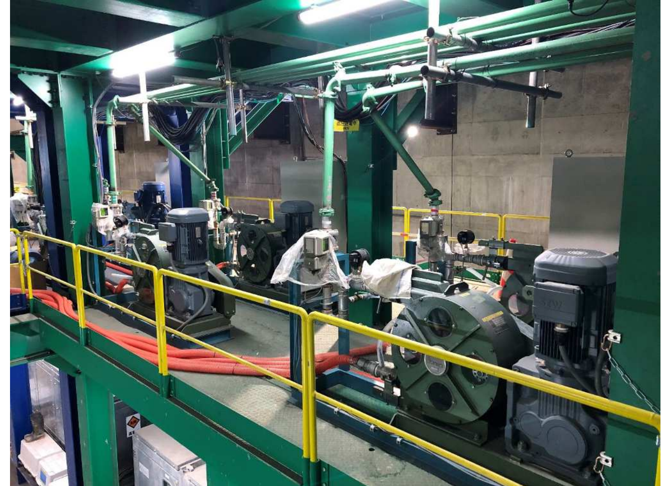
起泡溶液 注入ポンプ
