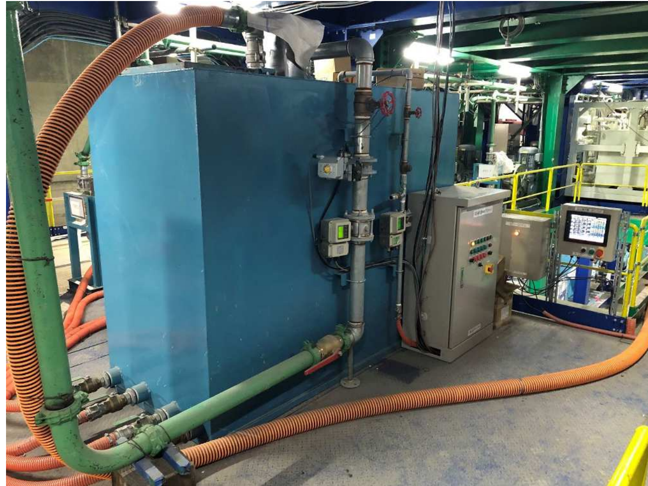
起泡溶液 作液タンク
