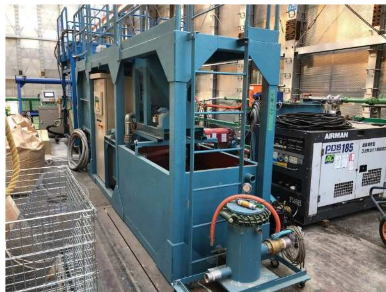
滑材注入プラント設置状況 (本掘進時は後続台車に搭載)
