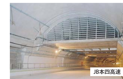
電気集じん機室の例
