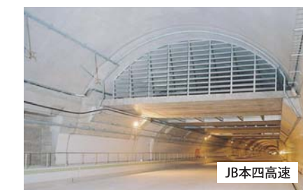
電気集じん機室の例
