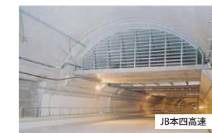
電気集じん機室の例
