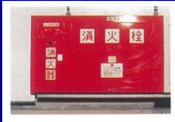
消火器・消火栓
