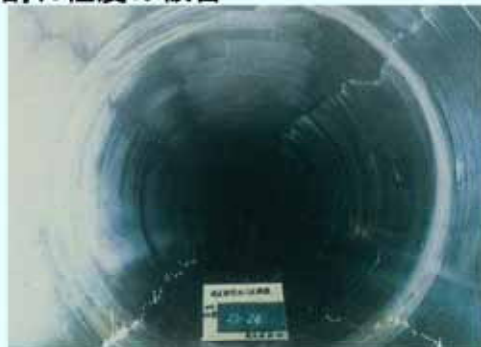
資料:阪神・淡路大震災調査報告 土木学会(鳴尾御影西污水幹線)
