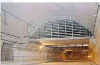
資料:JB本四高速(株) 写真:神戸淡路鳴門自動車道舞子トンネル 電気集じん機室(天井設置型)送気口
