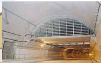
資料:JB本四高速(株) 写真:神戸淡路鳴門自動車道 舞子トンネル 電気集じん機室(天井設置型) 送気口
