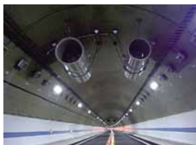
写真：近畿自動車道（紀勢線） 高田山トンネル 左：口径 1250mmφ型 右：口径 1000mmφ型
