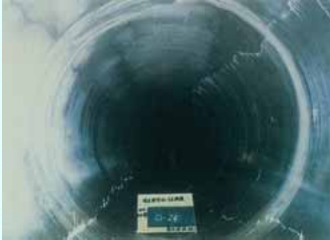
資料：阪神・淡路大震災調査報告 土木学会（鳴尾御影西污水幹線）
