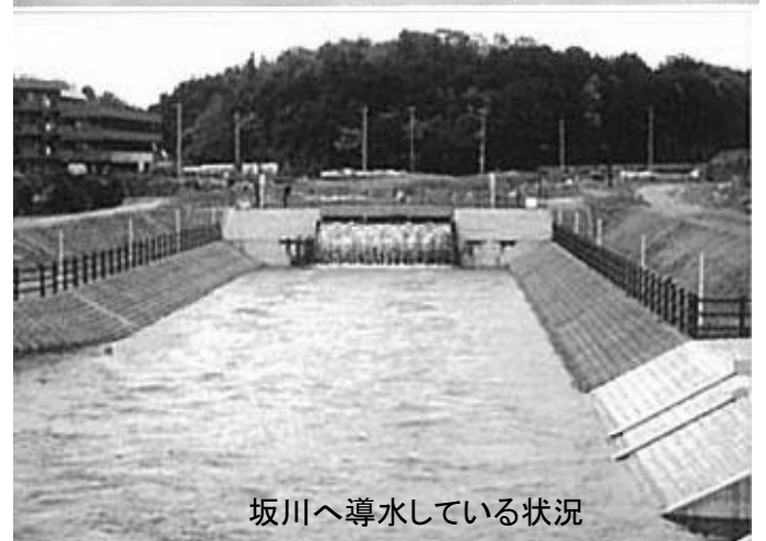
松戸排水機場
