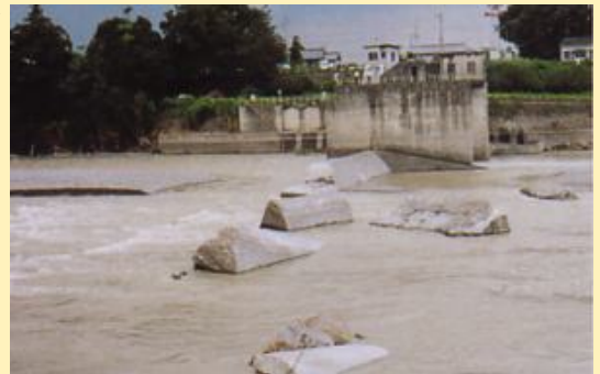
壊れてしまった六堰頭首工
