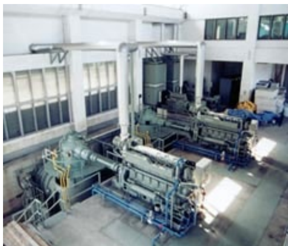
ポンプ室フロア
