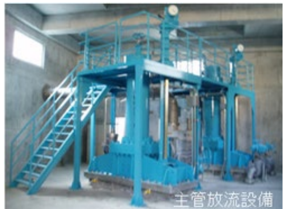
主管放流設備
