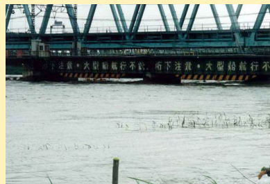
京成押上線橋梁に迫る洪水
