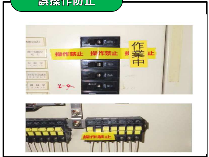
ステッカーによる操作禁止の明示
