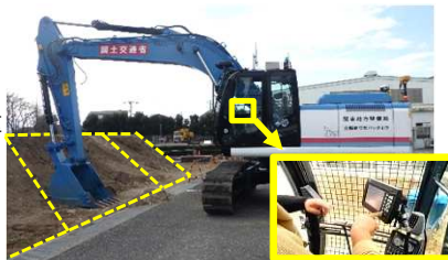
3次元マシンガイダンス搭載バックホウによるICT施工実習
