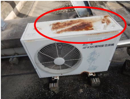
塩害により錆・腐食が発生した屋外機
