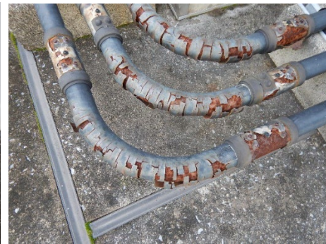
配管塗装が剥がれ配管まで腐食している状況
