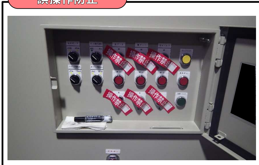
ステッカーによる操作禁止の明示
