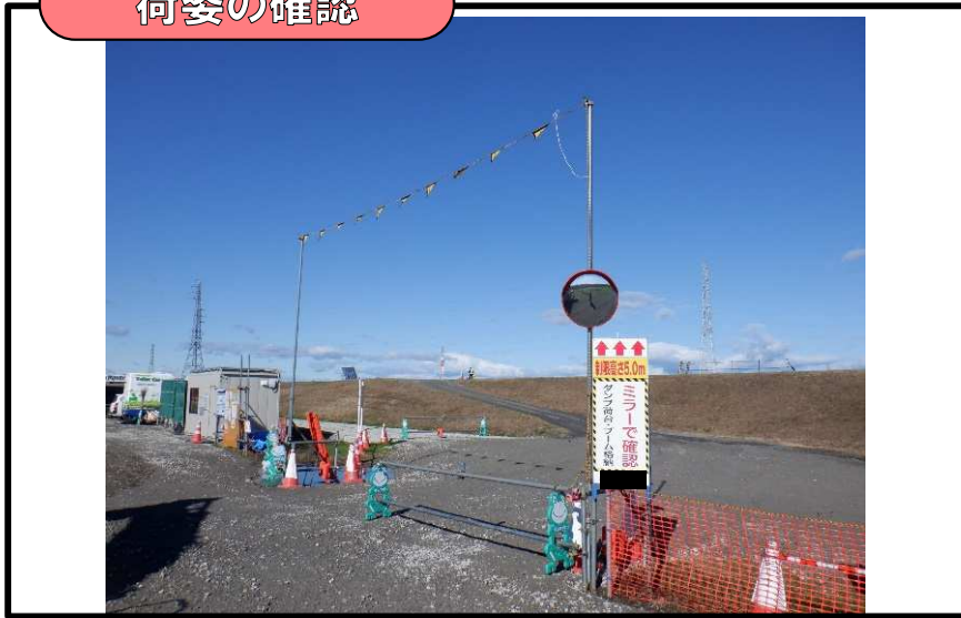
出入り口前に荷姿確認用ミラーを設置
