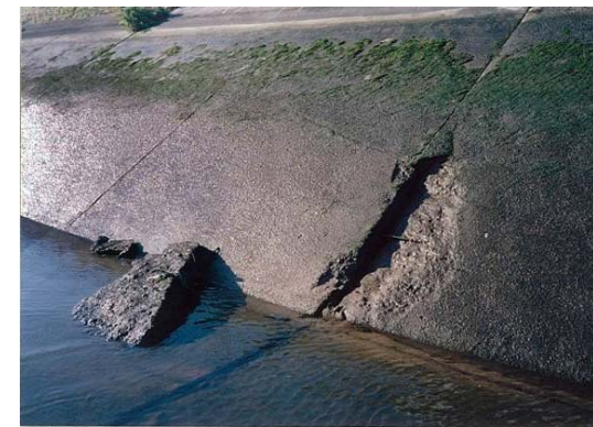
ライニングパネルの損傷状況
