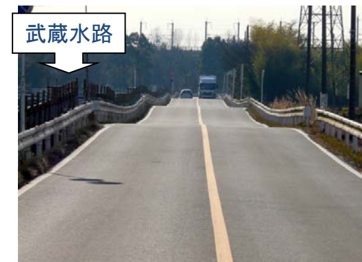
不同沈下の状況
