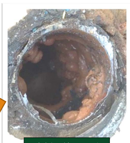
内側に錆こぶが 発生している
