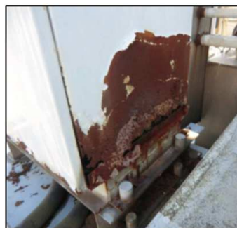
屋外キュービクルの劣化
