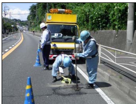
〈路面補修：ポットホール〉
