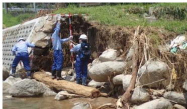
河川構造物の被害状況調査(添田町)
