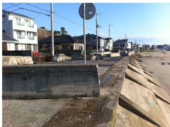
写真-1 被災状況：金沢地区海岸（日立市）
