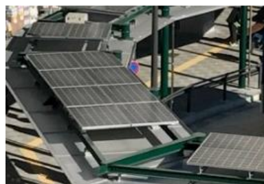
(太陽光パネル)
