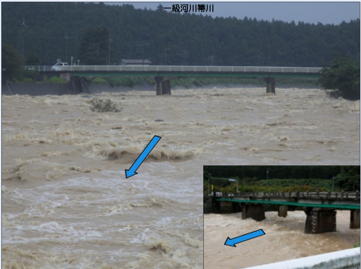
洪水時の堰場橋の状況
