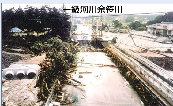
流木の影響により一部が落橋した余笹橋 （栃木県那須町）1998年
