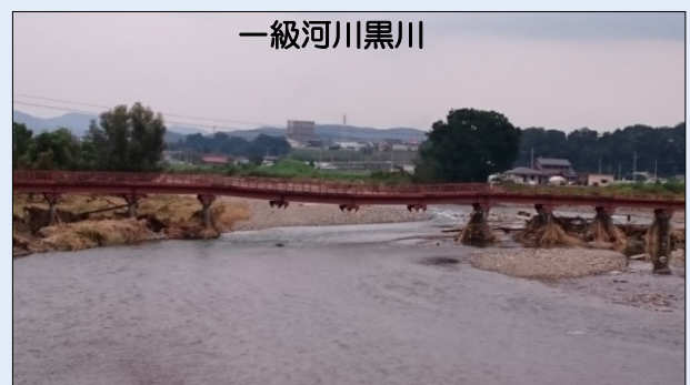
流木の影響により橋脚が流失した上殿橋 （栃木県鹿沼市）2015年
