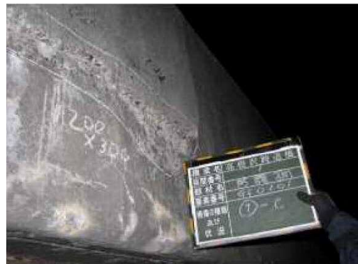
＜鉄筋露出状況＞
