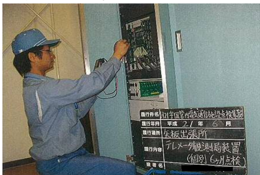
〈電気設備点検〉
