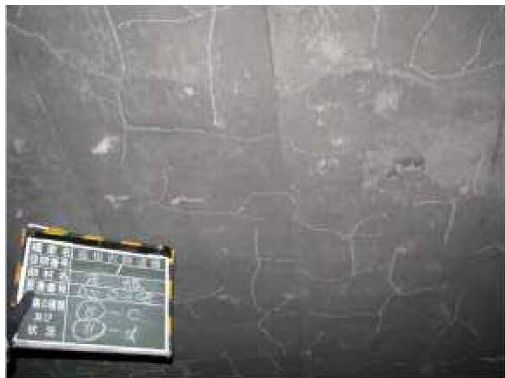
＜ひび割れ状況＞
