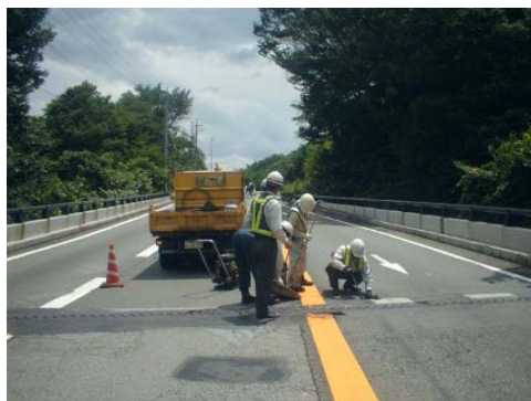
〈路面段差確認〉
