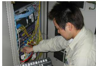
〈設備点検（通信設備）〉
