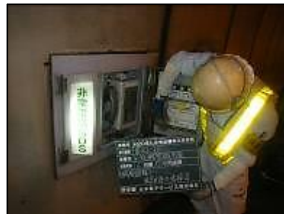
〈トンネル非常警報施設点検〉
