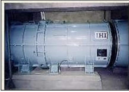
〈新笹子トンネル換気設備〉 （国道20号 大月市笹子町）
