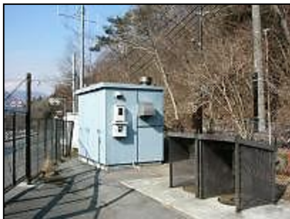
〈本栖橋ロードヒーティング設備〉 （国道139号 富士河口湖町本栖）
