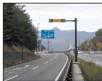
〈冠水警報板〉（スバル立体）
