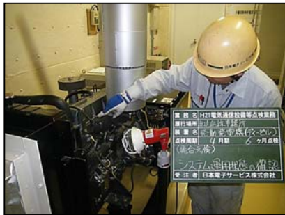
〈無線中継所非常発電設備点検〉
