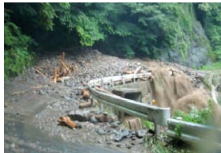
【写真2】平成22年7月14日 土砂崩落
