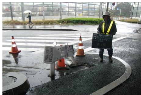
<ガードレール損傷確認>
