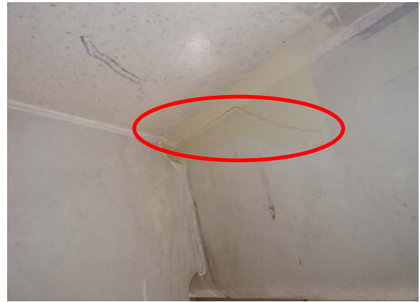
<ひび割れ箇所の例>
