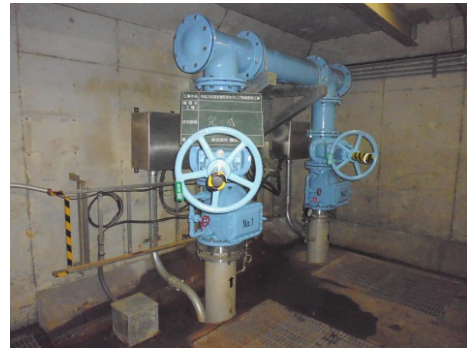
<道路排水設備：新善町 排水ポンプ>
