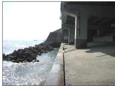
写真-3 西湘バイパス金波橋付近の被災状況
