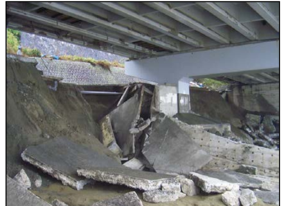
写真-4 二宮町周辺の被災状況
