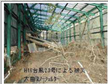
平成16年の台風による被害(2)
