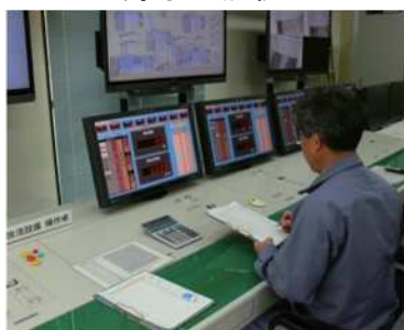
電気設備点検 (ダム管理用制御処理設備)
