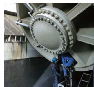
機械設備点検 (ホロージェットバルブ)
