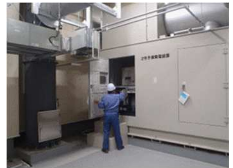
発電機点検保守
