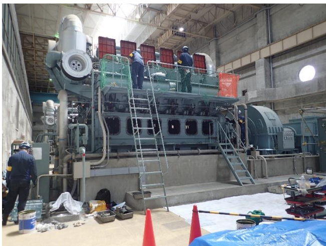
機械設備の点検・整備
