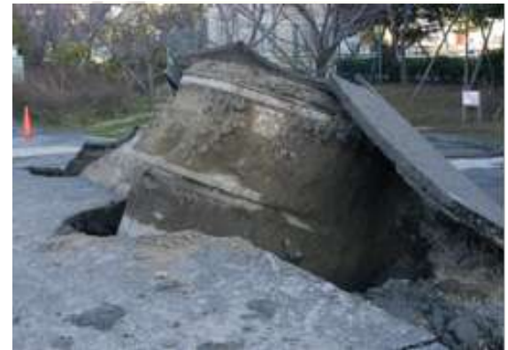
液状化でマンホールが飛び出した道路（船橋市）
