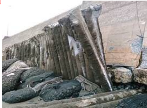
護岸擁壁洗掘状況
