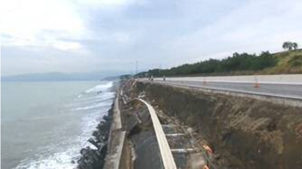
護岸及び道路崩落状況
