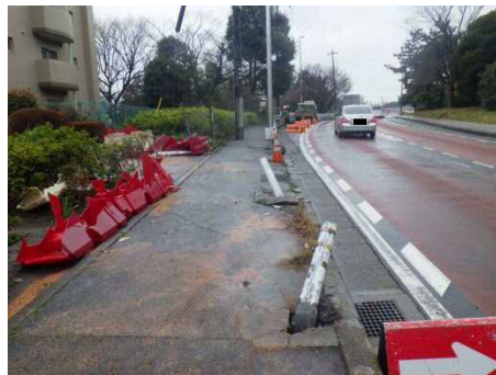
■ 事故による歩道の損壊 後日、応急復旧 (H29.4.1)
