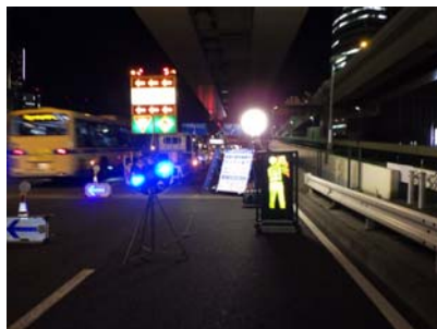
▲通行規制の状況 (H27.5)
