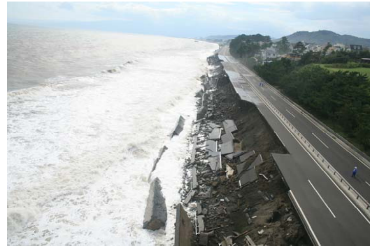
被災状況(平成19年9月7日)
