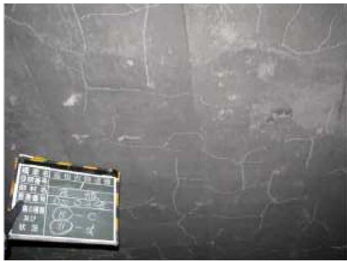
< ひび割れ状況 >
