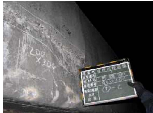
< 鉄筋露出状況 >
