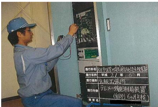
〈電気設備点検〉
