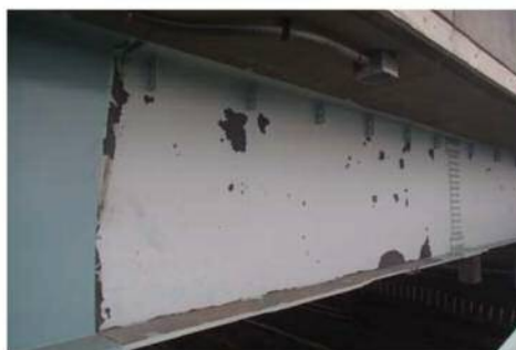
主桁防食機能(塗装)劣化状況
