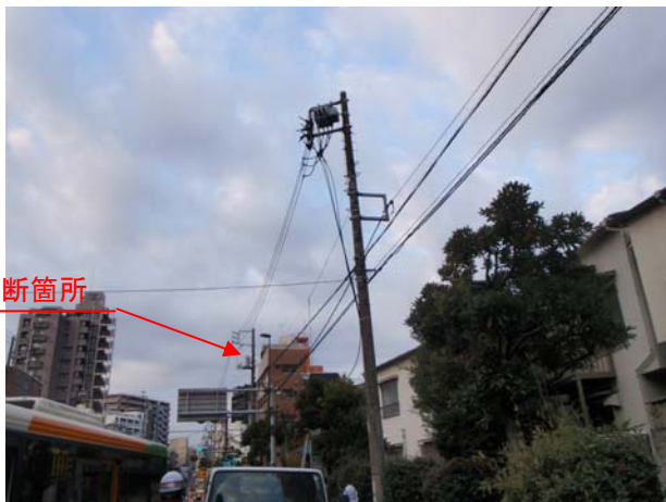
電線切断時の状況
