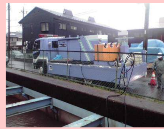
布佐地区: 床下・床下浸水 およそ400棟
